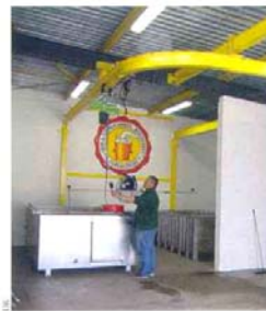
▲ Appareil de levage pour transfert des produits décapés jusqu'à la zone de lavage.
